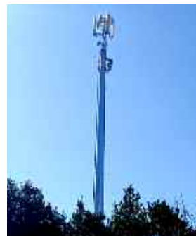
L'antenna installata in via dell'Infernaccio
